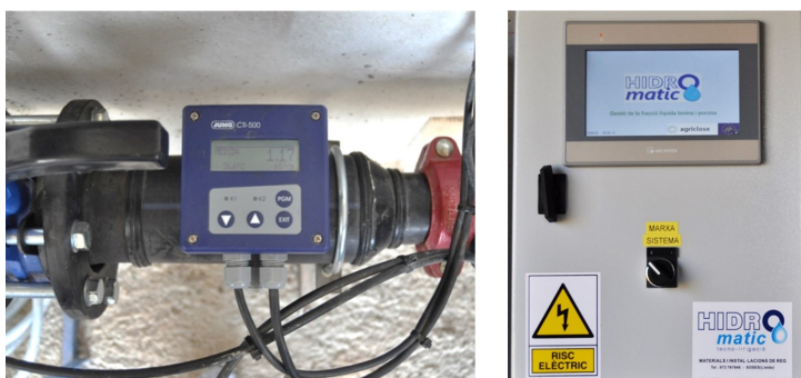
Figura 2. A. Conductímetre instal·lat en el sistema de reg (LIFE Agriclose). B. Programador automàtic de la dosificació de la fracció líquida (LIFE Agriclose).
