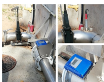
Figura 2. Conductímetre fix a la bassa
